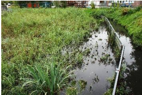
Schilfsedimentationsanlage Sander Damm
